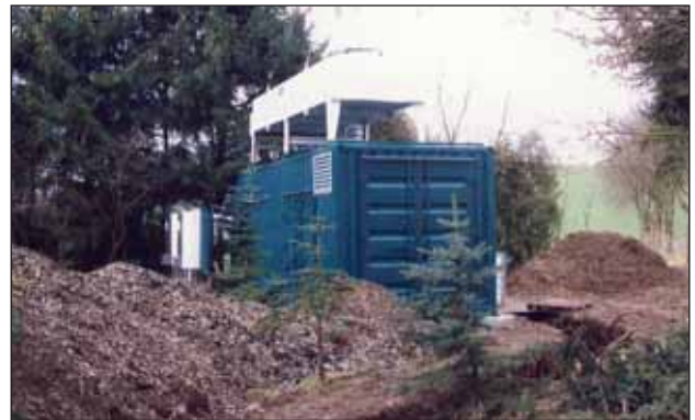
Blockheizkraftwerk bei Orchideen-Koch
