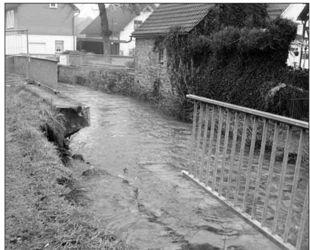
Die Twiene nach dem Einsturz der Stützmauer
